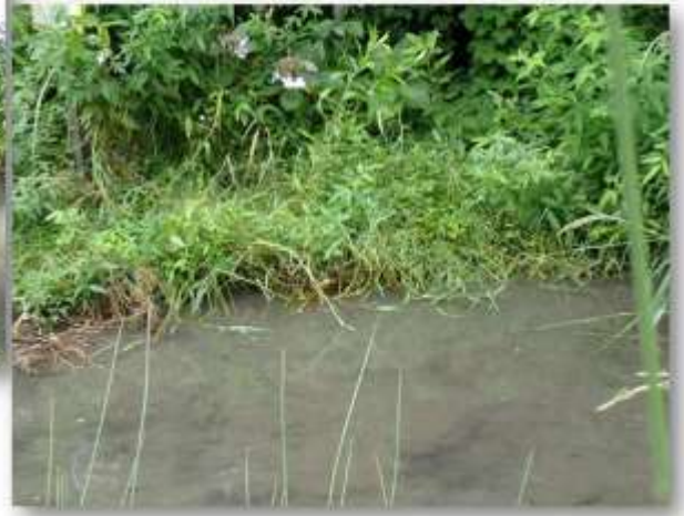
粗朶がなくなった部分は水没している 240713
