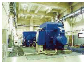
電気をつくる機械 (発電機)
