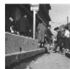
地盤沈下のようす
