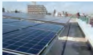
小学校の屋上にある太陽光発電せつび (生野区 東桃台小学校)
