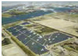
夢洲のメガソーラー 10,000キロワット、(約3,200軒分の家の電力消費量)の発電せつびを設置しています。
