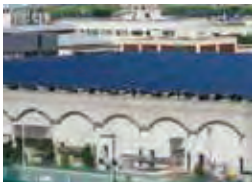
柴島じょう水場 合計400キロワットの発電せつびを設置しています。
