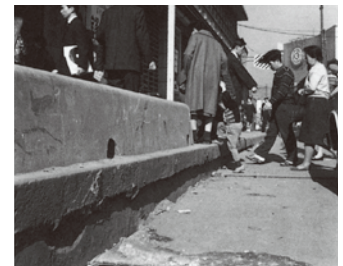
道路の地盤沈下 (1960年頃の阪急梅田駅) (出典：写真で見る大阪市100年)
