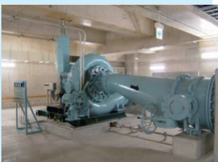
長居配水場の小水力発電
