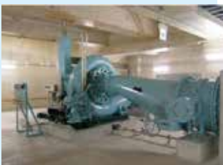
長居配水場の小水力発電
