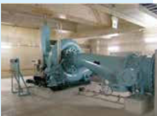
長居配水場の小水力発電
